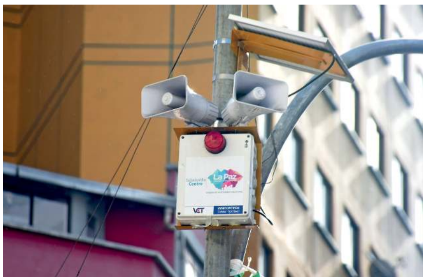
Alarma comunitaria instalada en la zona El Rosario.
