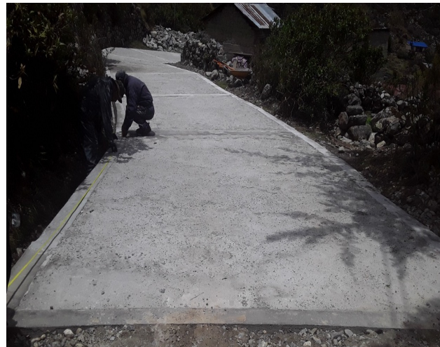
MEJ. VIAL TRAMO INGRESO A LA COMUNIDAD A CURVA U. EDUCATIVA DE PROG. 0+250 A PROG. 0+300 COMUNIDAD LLAULLINI
