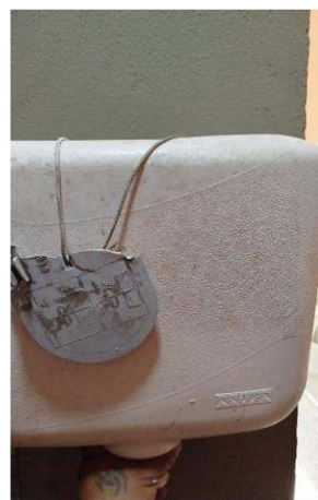
Sifones sucios y tanques dañados
