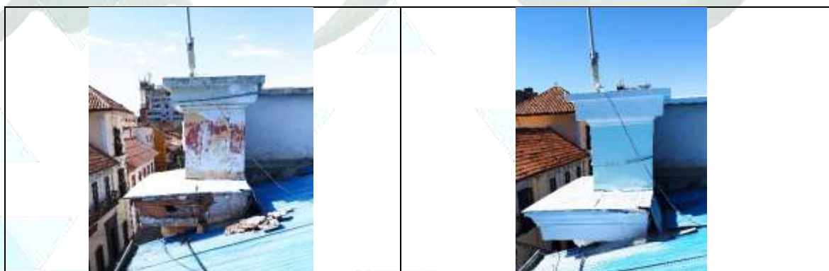
Perdida de moldura y revoque
