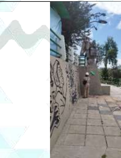
Conservación preventiva de la pintura mural esgrafiado
