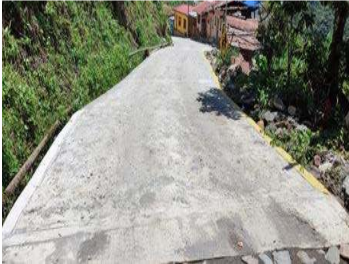
MEJ. VIAL TRAMO DESDE LA UNIDAD EDUCATIVA HACIA EL PUENTE YAHUILACA COMUNIDAD CAHUA GRANDE
