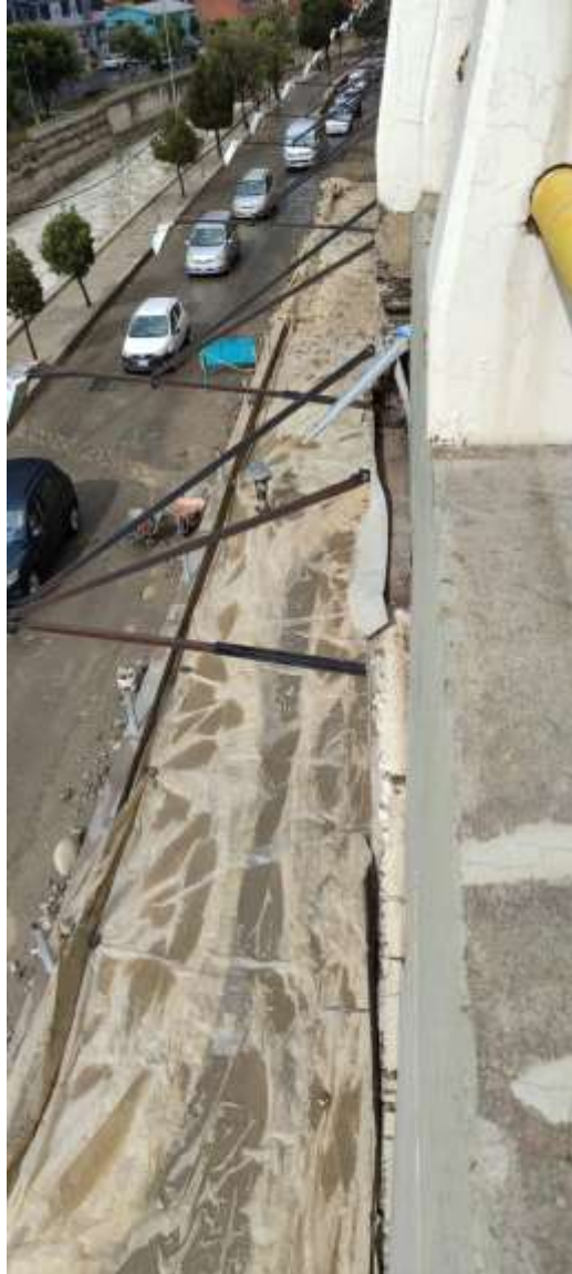
Fotografía 4. Desplazamiento que muestra un movimiento de vuelco en el muro, siendo este un signo de falla en este sistema de contención.
