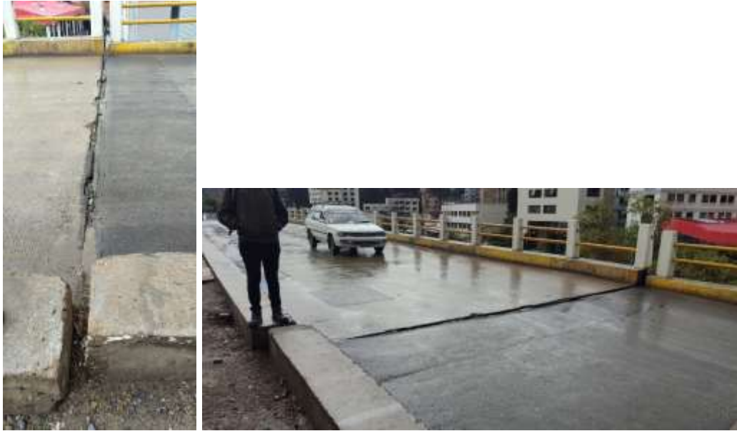
Fotografía 5. Sector donde presenta vibraciones y pérdida de continuidad en la losa de continuidad de los muros.
