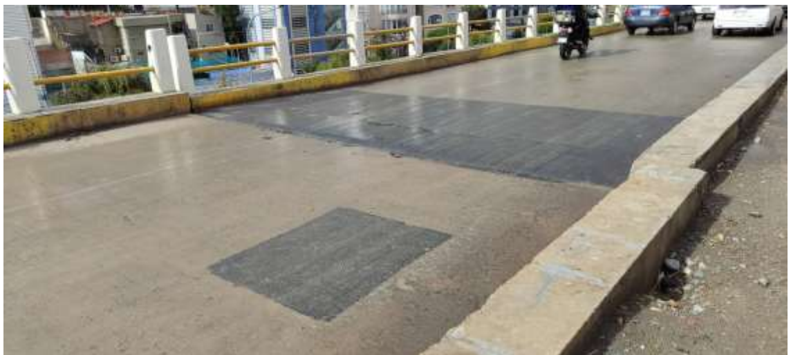
Fotografía 3. Desplazamiento en el muro cajón
